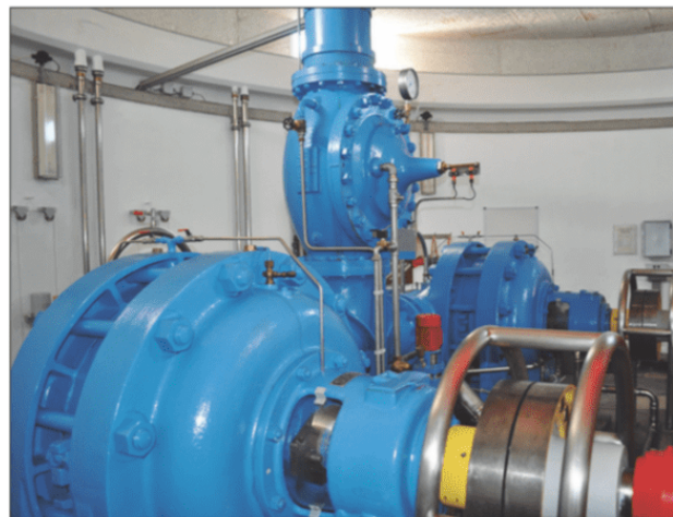
DANS LES ENTRAILLES du Jet d'Eau: deux pompes propulsent chaque seconde cinq cents litres d'eau.
